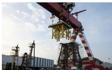
A Saint-Nazaire il sert aux EMR (ici assemblage de sous station électrique)
